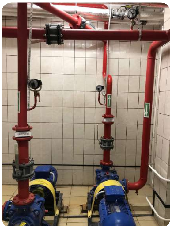
ИНДИВИДУАЛЬНЫЙ ТЕПЛОВОЙ ПУНКТ
